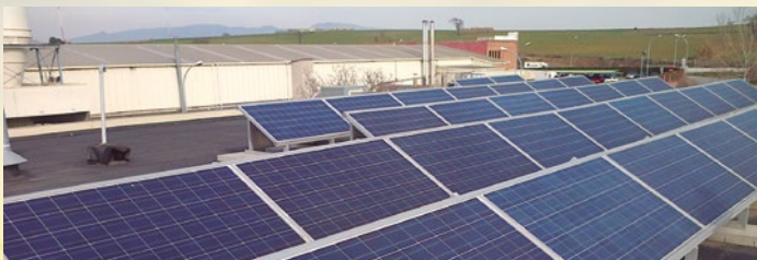
Instalações em âmbito industrial ou sector terciário
