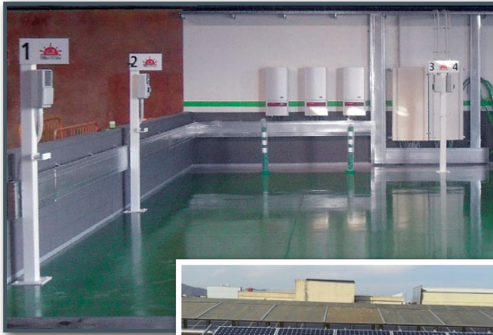
Interior e exterior de las instalaciones de URBASER, donde se ha puesto en marcha el proyecto RECARGO
