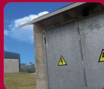
Centres de transformation
