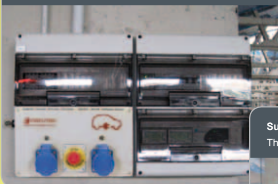
Subcuadro de cargas monofásicas Single-phase load sub-panel
