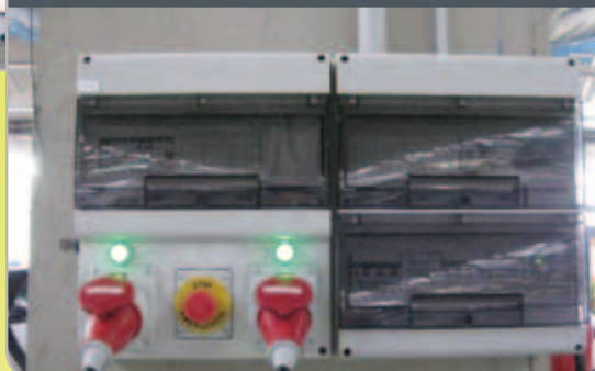
Subcuadro de cargas trifásicas Three-phase load sub-panel
