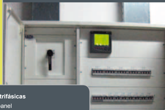
Cuadro general de distribución Mains distribution panel
